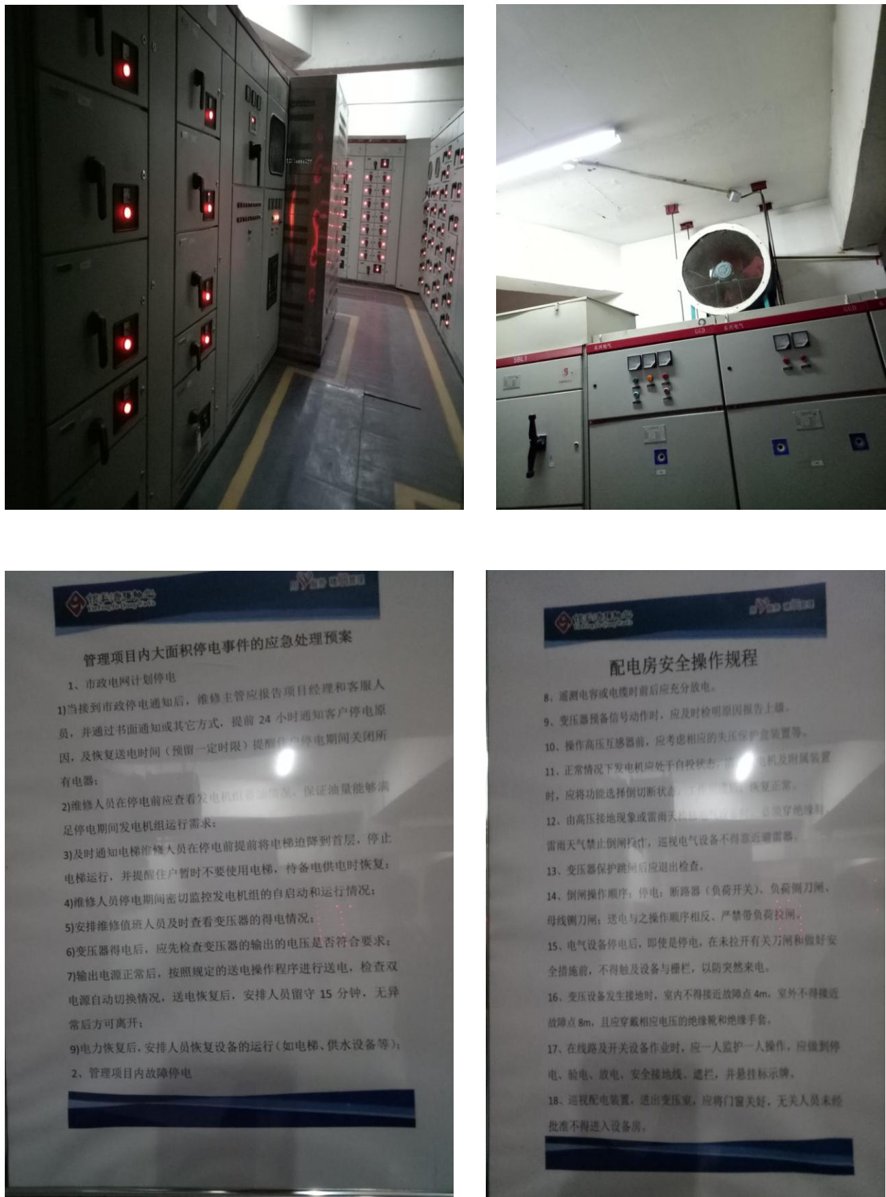
附图 9：变电房、加压水泵房、发电机房
