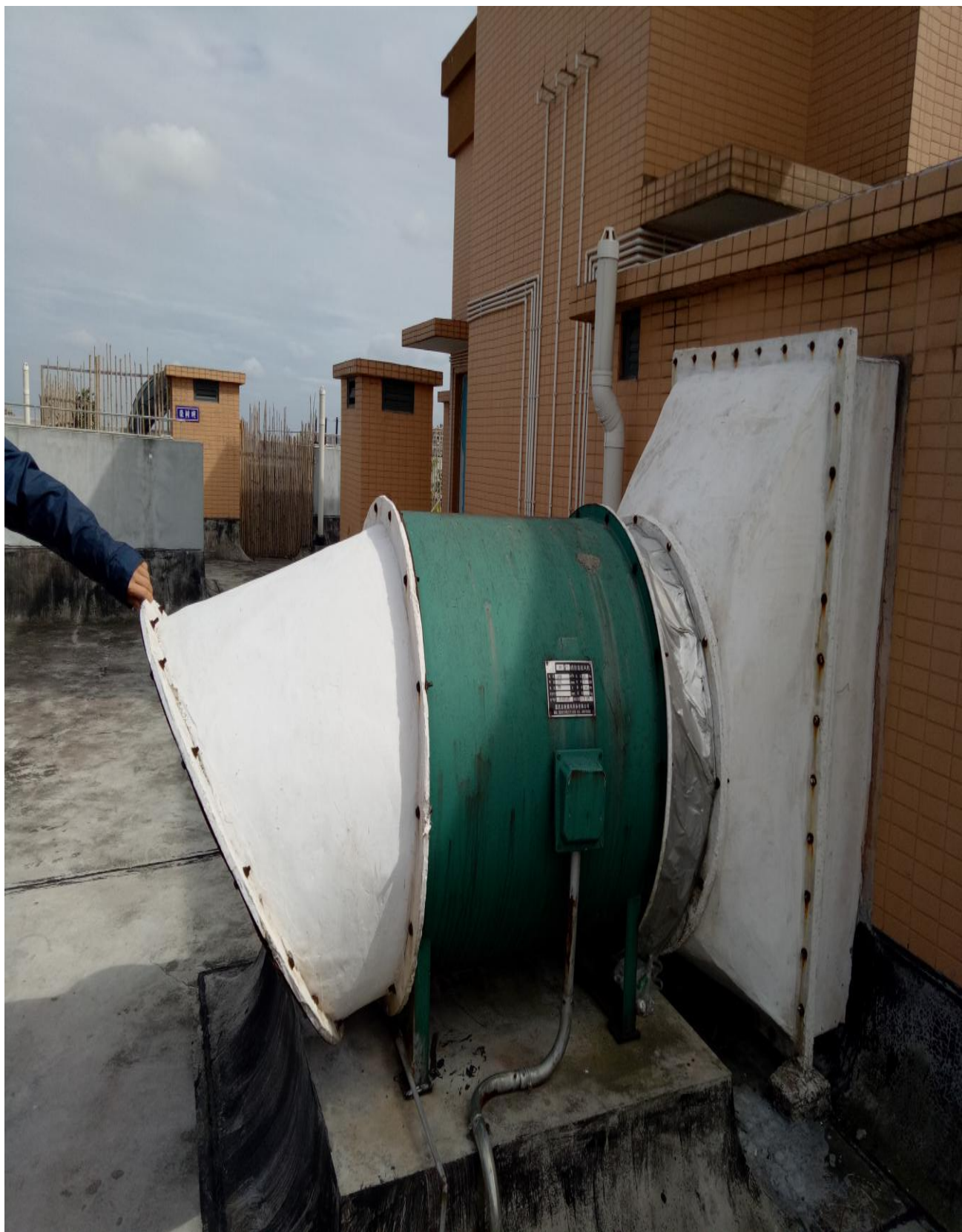
附图 7：地下室发电机组废气排放口
