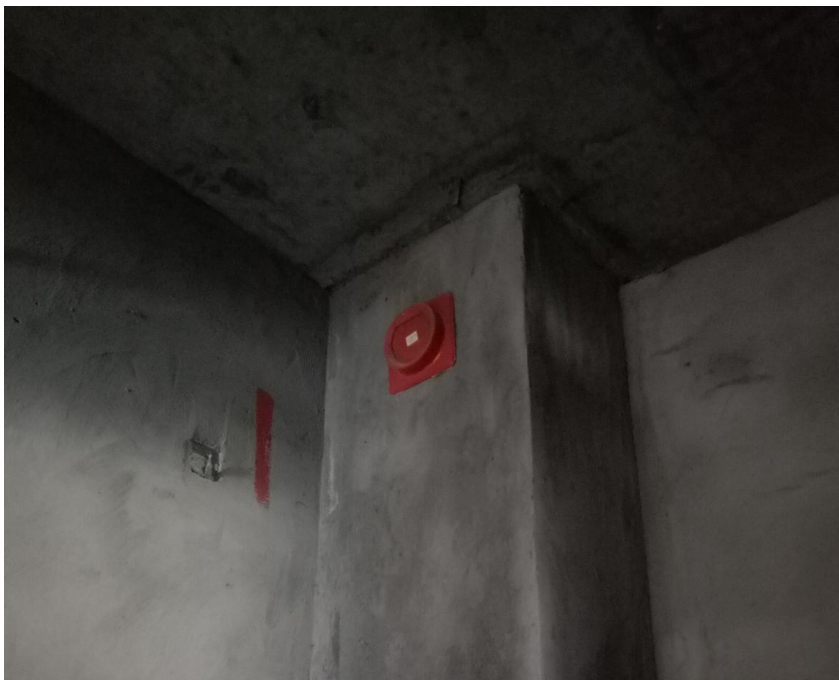
附图 17：厨房预留油烟排放口、燃气泄漏报警装置
