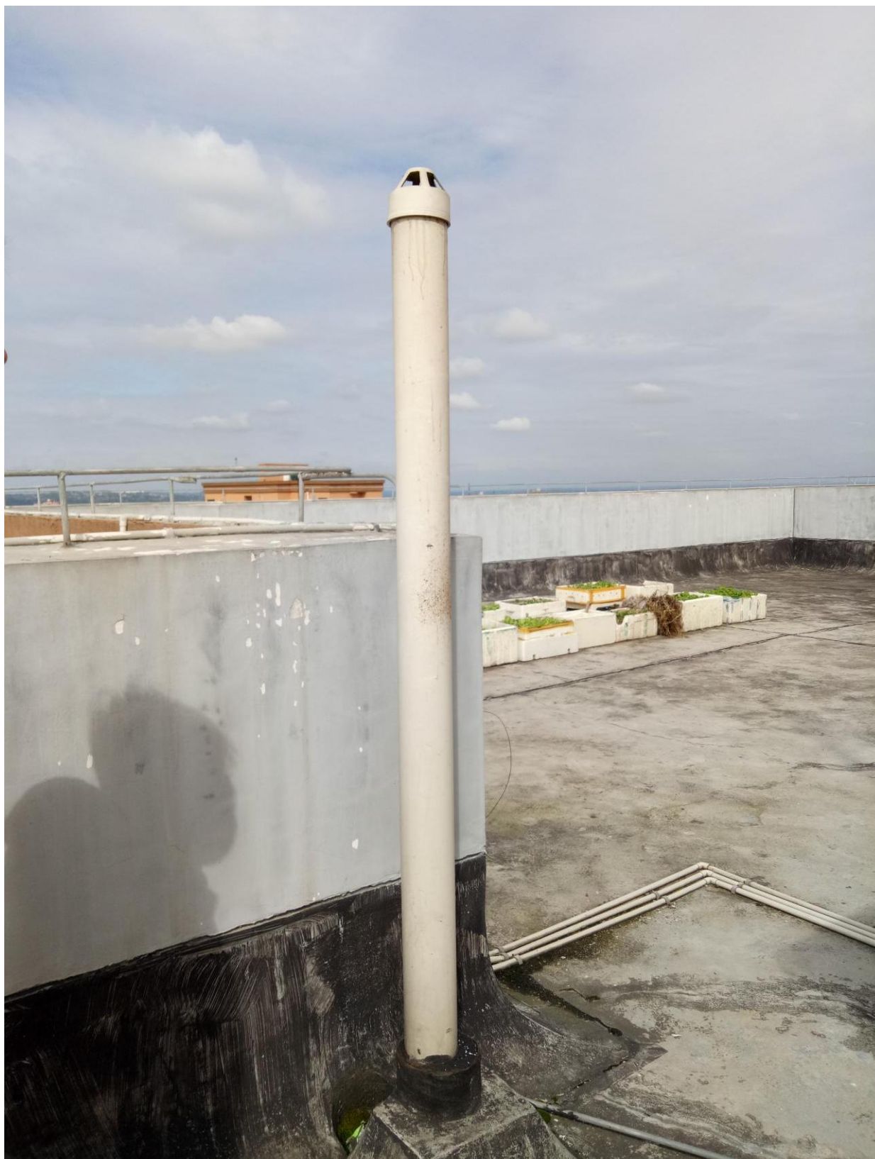
附图 9：化粪池楼顶废气排放出口
